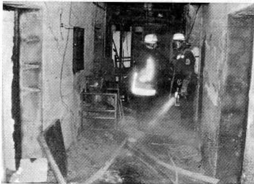
Durch das Feuer wurde der Bereich der Gemeinschaftsräume der Kurklinik Rabenstein in Bad Salzhausen völlig zerstört.
