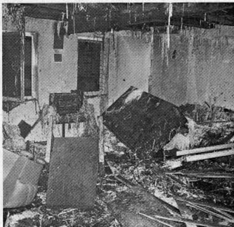
Ein Anblick der Verwüstung im Innern des Gebäudes.
